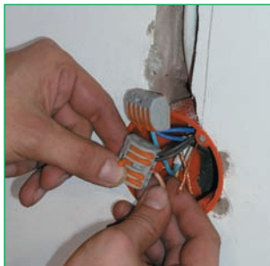
▲ Электрические соединения в сервисной коробке
